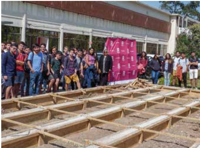
Comenzaron los trabajos de construcción del recinto que promoverá la vida saludable entre los estudiantes del Campus Santiago.
